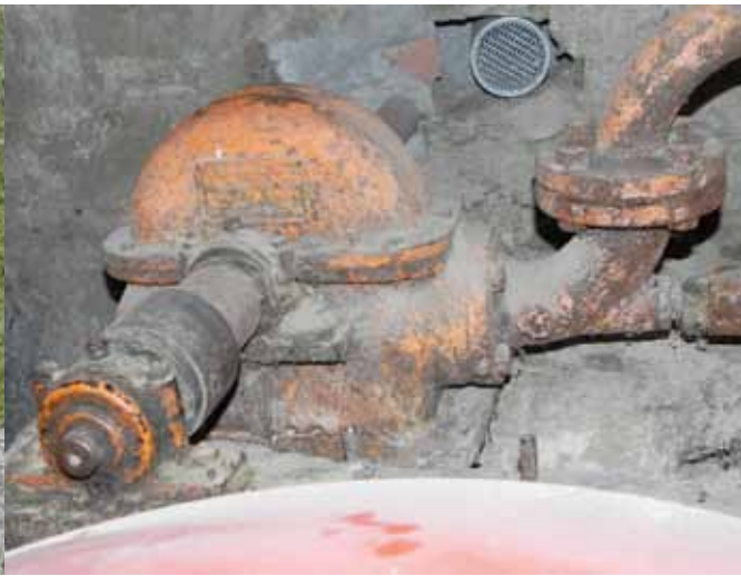
Altes Turbinengehäuse. Darin verborgen ist die Turbine, welche früher der Stromerzeugung diente.
